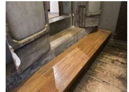
蔵戸前：比較的状态が良く修復可能
