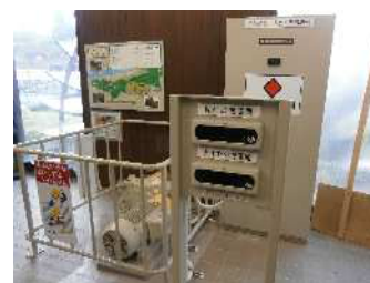
小水力発電設備
